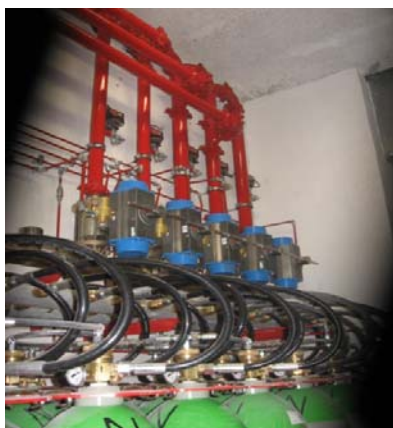
Slika 3: Povezava jeklenk stabilne gasilne naprave I3 s cevovodnim razvodom
