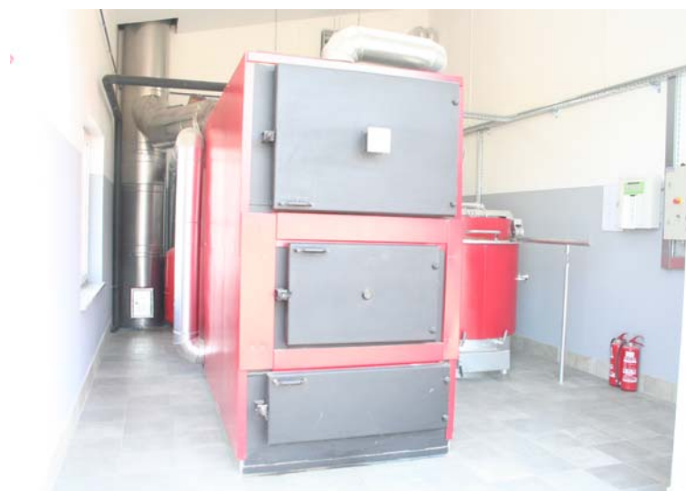
Slika 2: Notranjost kotlovnice na lesno biomaso podjetja Žagarstvo Volk
