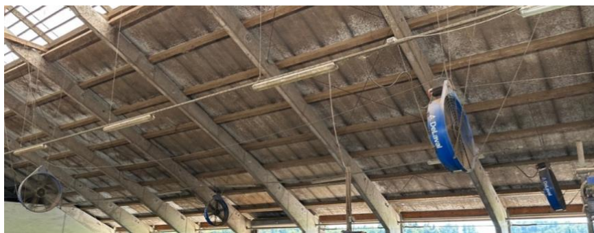
Slika 9: Sistem ventilatorjev za prezračevanje
