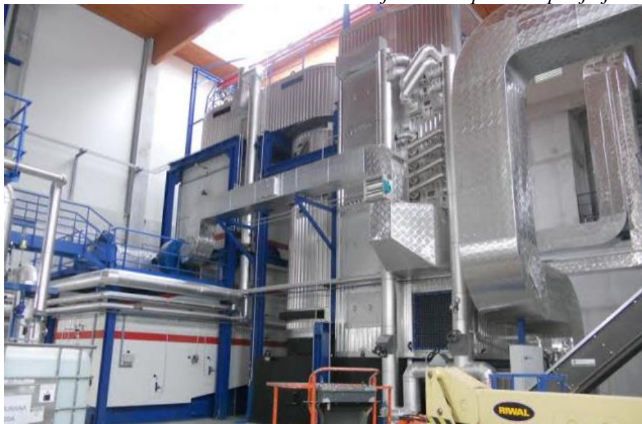
Slika 1: Kotlovnica Kohlbach in sistem za čiščenje dimnih plinov v podjetju Esol
