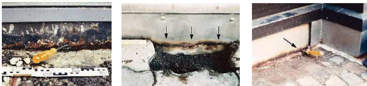
Slika 26: Primer poškodb pri pocinkani pločevini, aluminiju in jeklu krom nikelj 18/8 zaradi nepravilne izvedbe
