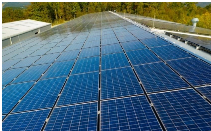
Slika 4: Sončna elektrarna na strehi objekta
